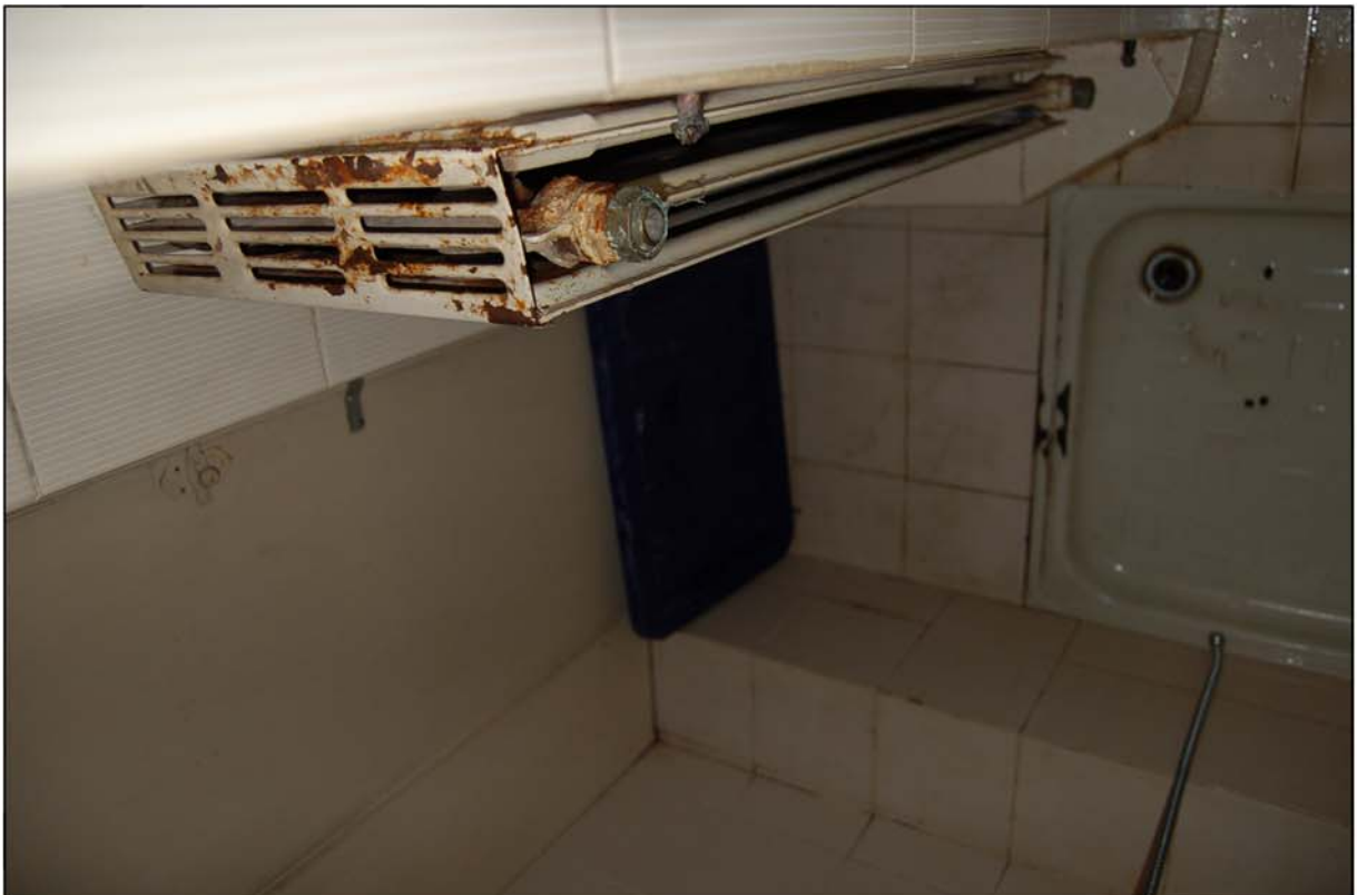
- Foto n°10 - Dettaglio piatto doccia e sportello d'accesso ad un pozzo
