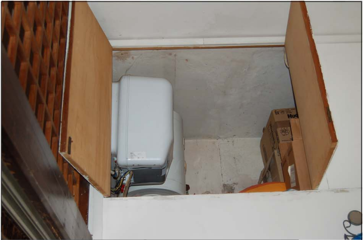
- Foto n°19 - Vano interno all'immobile per alloggiamento scaldabagno
